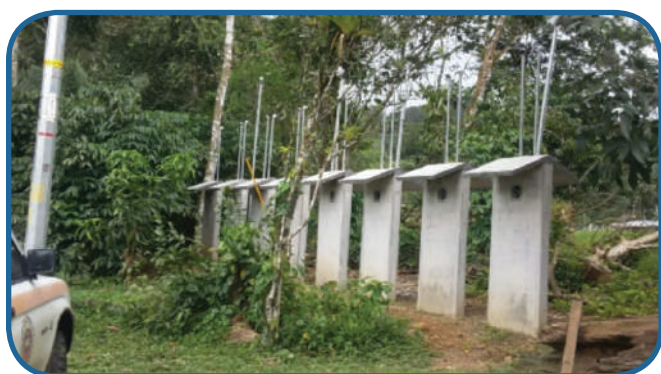
OER – Acometida eléctrica en la comunidad de San Pedro de Coclé
