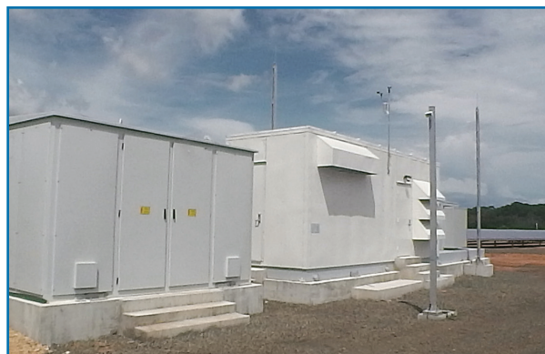
Imagen de los Inversores AC - DC y la Cabuna de Media Tensión.
